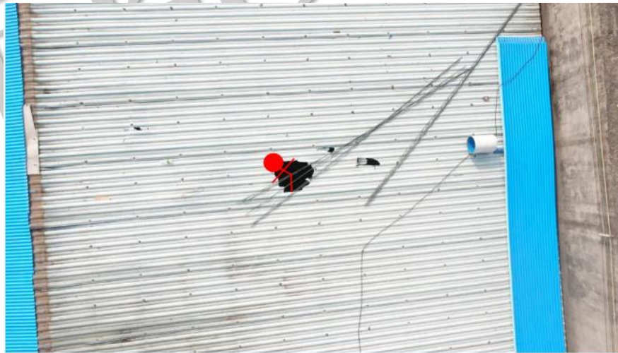
4 发生事故的厂房外棚顶
